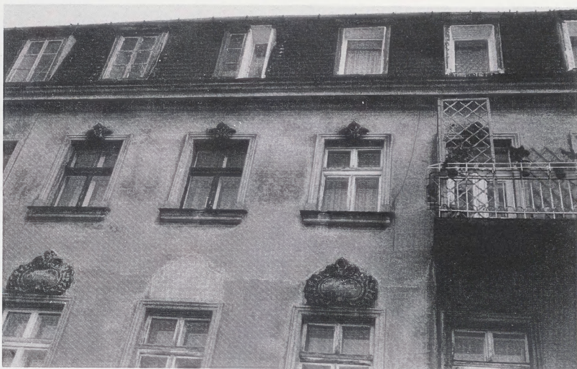
10. Zniszczone okna w mansardowym dachu kamienicy przy ul. Madalińskiego 9. Widok od strony Wisły (fot. M. Christian)
