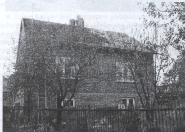
Zniszczona część dachu na domu w Zawadzie
