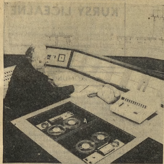
Fragment głównej dyspozytorni Zakładu Energetycznego Kraków-Miasto.
