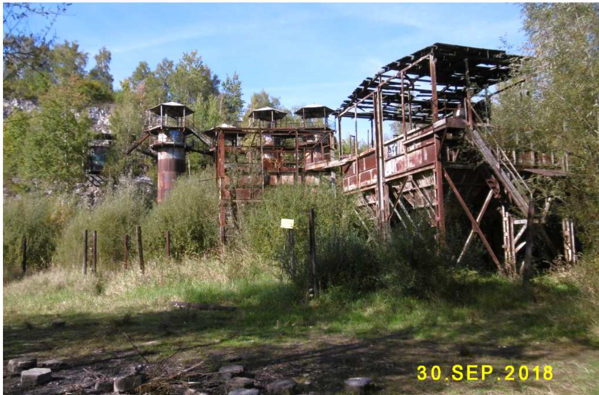
Fot. nr 343. Przerdzewiała instalacja przeróbki wapienia w ujęciu z niecki.
