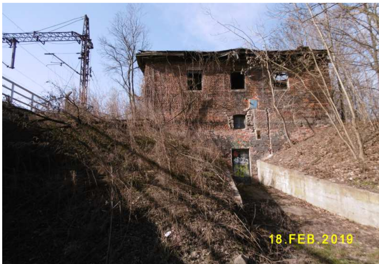
Fot. nr 402. Opuszczony budynek kolejnej rozrządówni w sąsiedztwie ulicy Stacyjnej.
