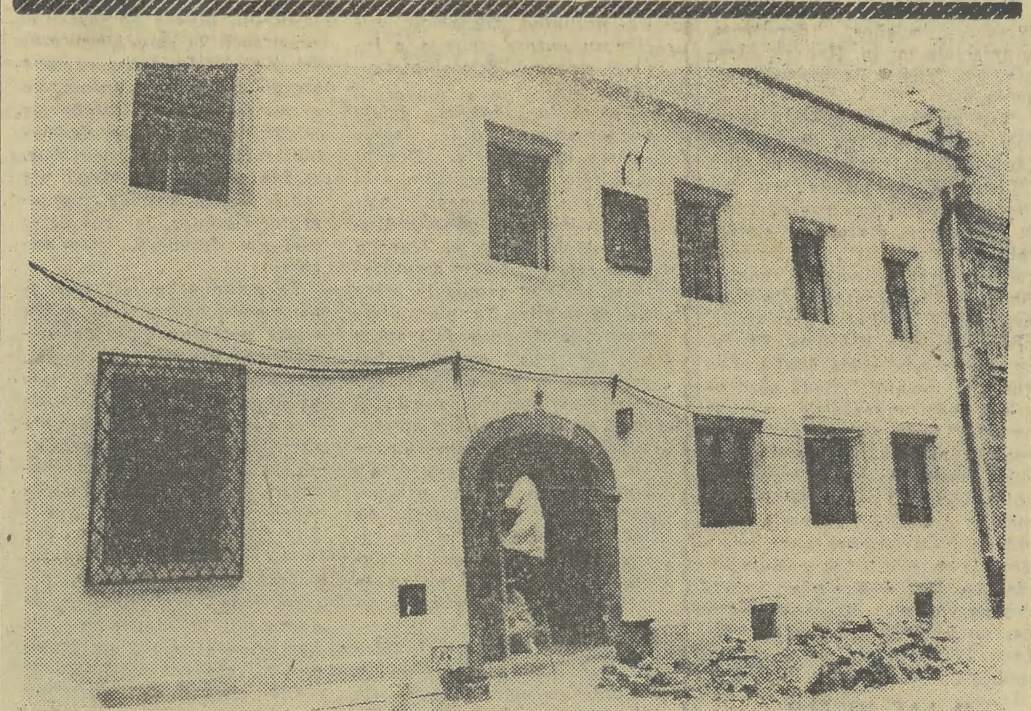
Jeszcze trochę czasu (czytaj: parę lat) a wszystkie fasady ul. Kanoniczej będą tak wyglądać. Na zdjęciu: kamieniczka pod numerem 6, którą zaczyna właśnie przejmować Towarzystwo Sztuk Pięknych. O cudenkach, jakie ten dom ma w środku — pisaliśmy szczegółowo przed kilkoma dniami. (k) Fot. JADWIGA RUBIS
