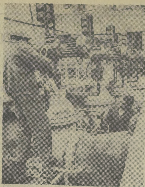
Przegląd węzła ciepłowniczego.
