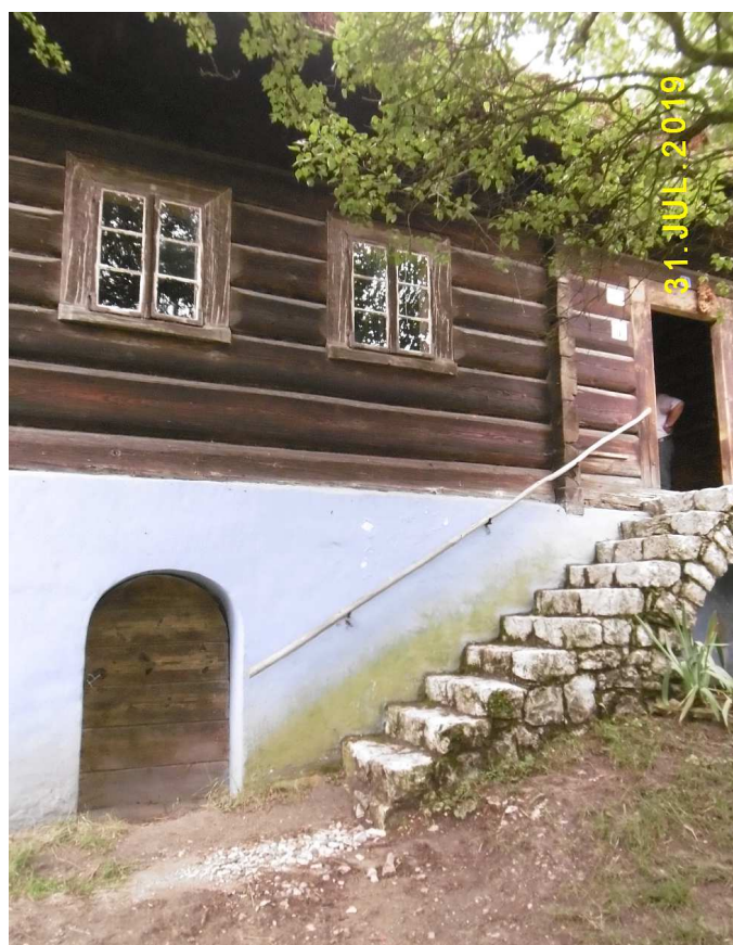
Fot. nr 26. Loch w części piwnicznej.
