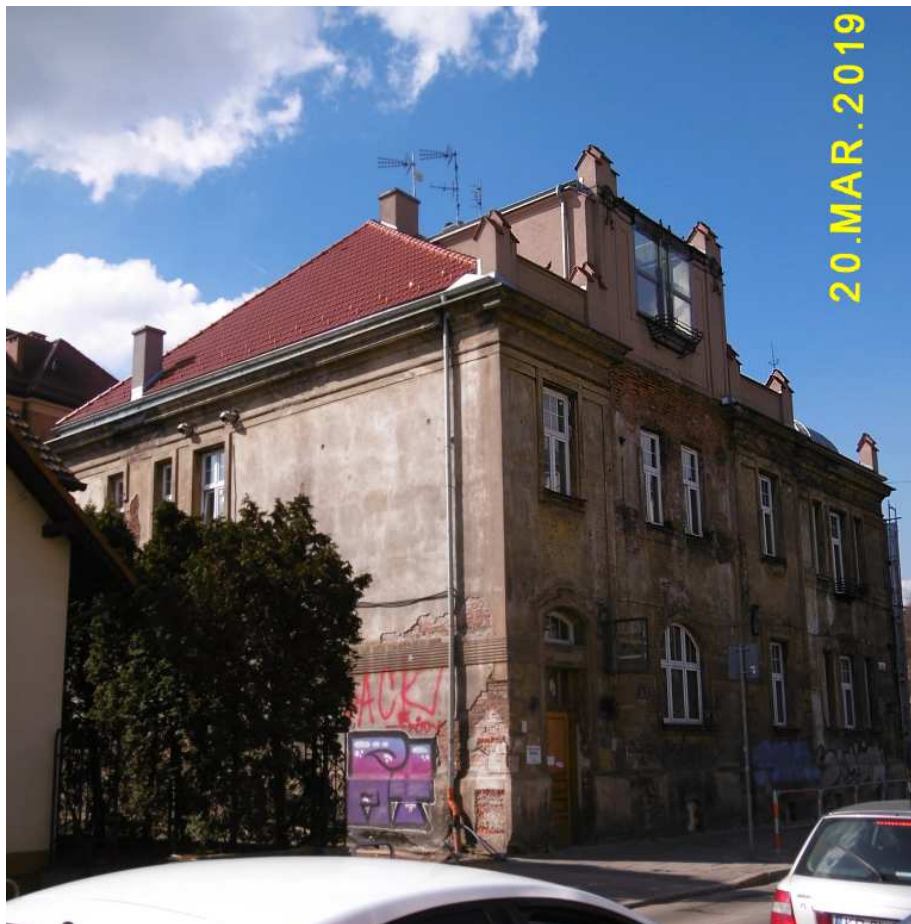
Fot. nr 253. Ciągłe zaniedbana secesyjna willa z ulicy Czarnowiejskiej 8.
