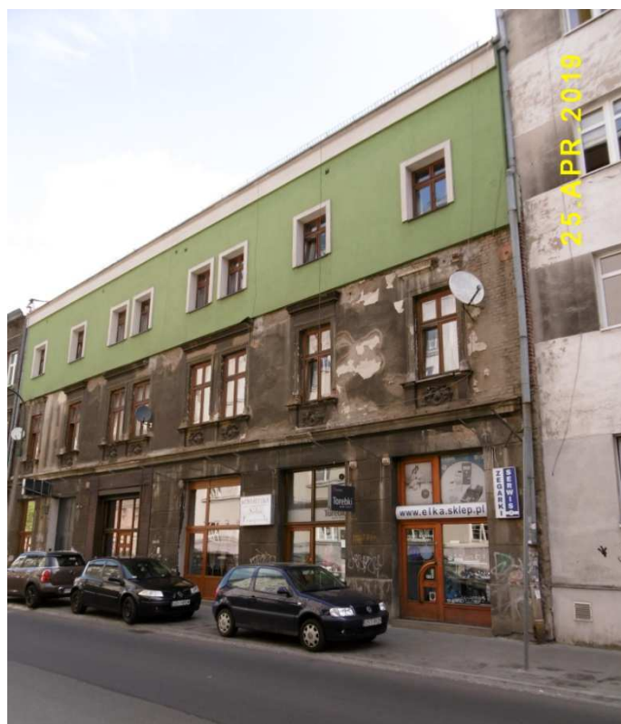
Fot. nr 122. Nadbudówka kamienicy przy ulicy Krowoderskiej 9, którą trudno komentować.
