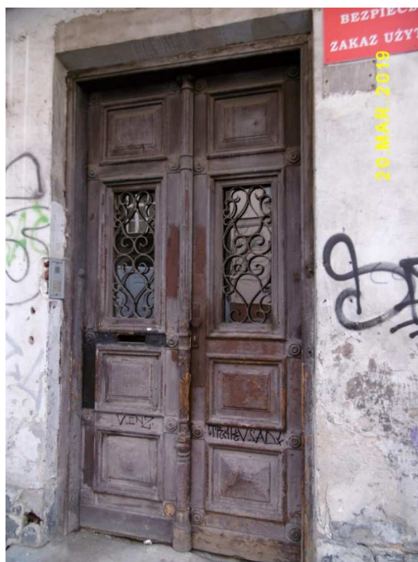
Fot. nr 270. Drzwi jeszcze do uratowania.
