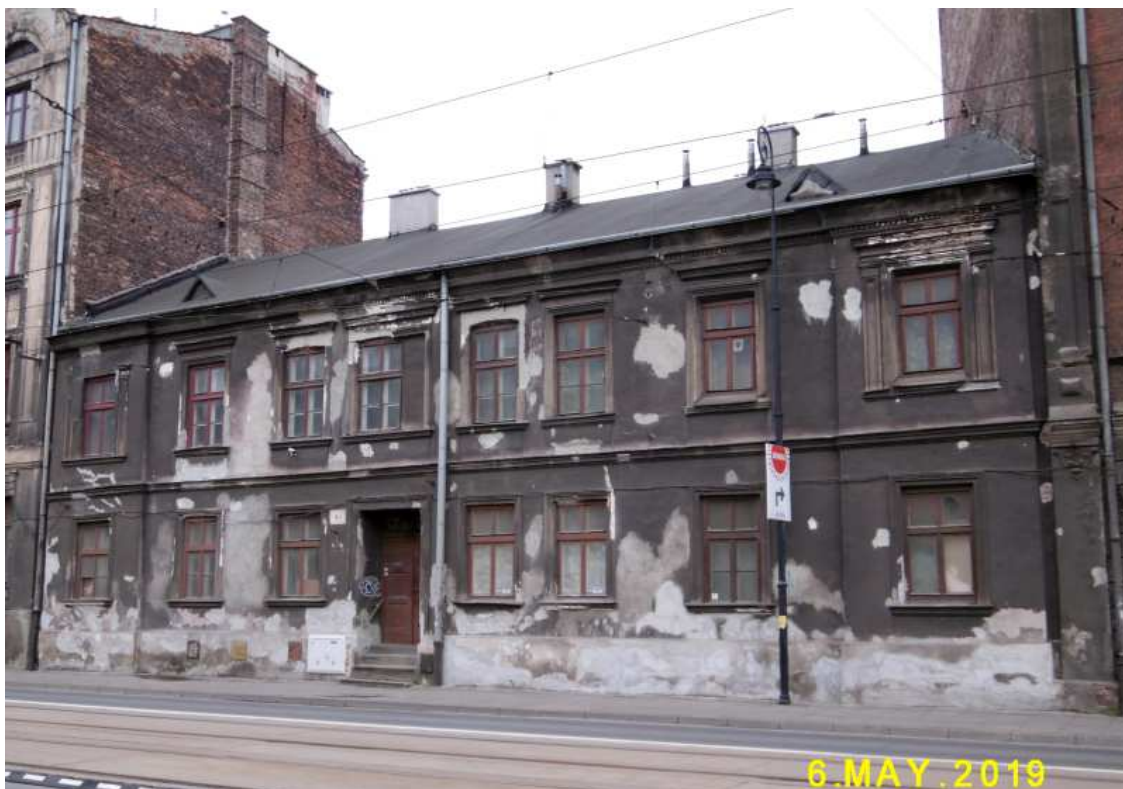
Fot. nr 126. Ostatnie tygodnie kamieniczki pod nr 40, wybudowanej w roku 1885.
