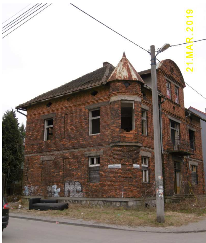
Fot. nr 302. Modernistyczna willa spod nr 12 podupadająca od kilkunastu lat.
