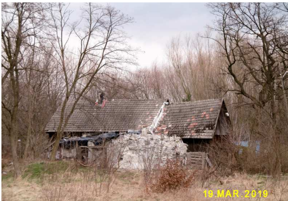
Fot. nr 173 (173-175). Mocno zniszczona i zaniedbana, ale ciągle zamieszkała chałupa przy ulicy Wspólnej 1.
