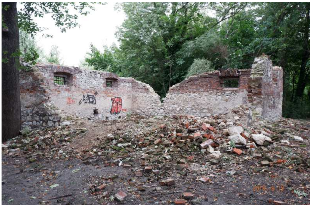
Fot. nr 201. Nieco uporządkowana ruina dawnego budynku gospodarskiego dworu w sąsiedztwie ulicy Laszczki
