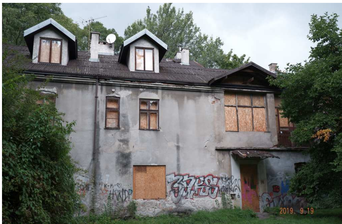
Fot. nr 201. Fasada z pozabijanymi dechami oknami i z wybitymi przez wandalę szybami.
