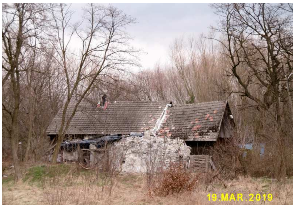
Fot. nr 417 (417-419). Mocno zniszczona i zaniedbana, ale ciągle zamieszkała chałupa przy ulicy Wspólnej 1.
