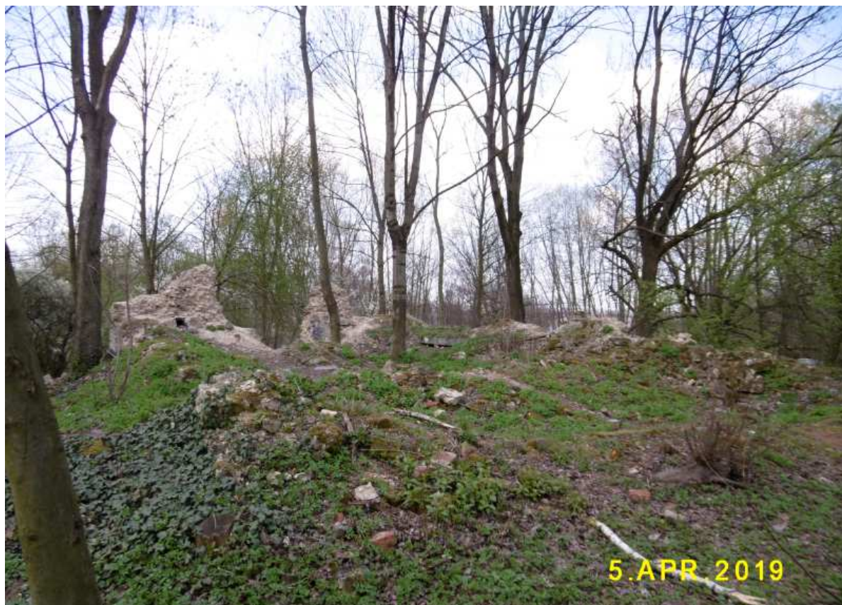
Fot. nr 414. Ruina kolejnego budynku gospodarczego we fragmencie w sąsiedztwie ulicy Albańskiej.
