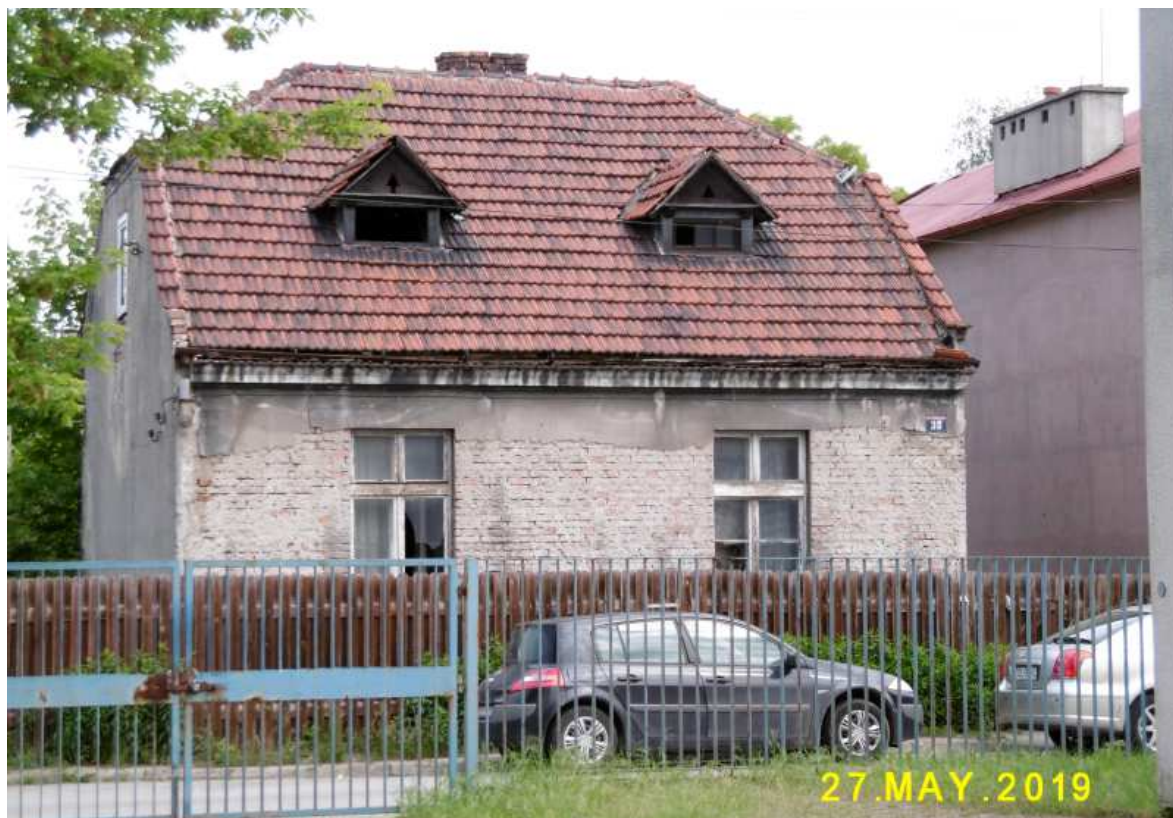
Fot. nr 56. Opuszczony dom spod nr 33.
