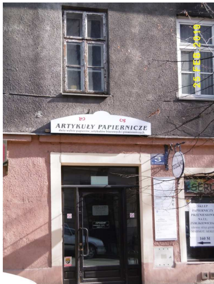
Fot. nr 36. Ostatnie oryginalne okno.
