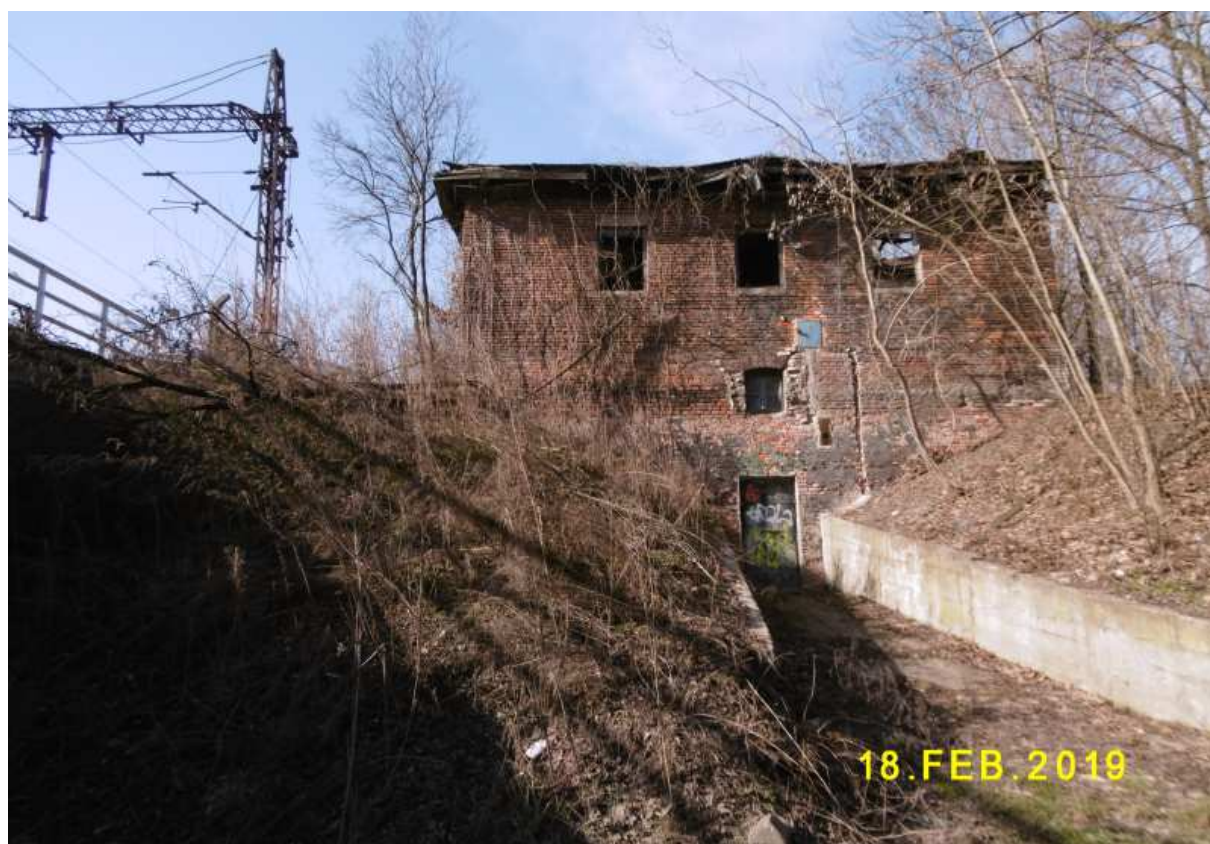
Fot. nr 459. Zrujnowana rozdzielnia.
