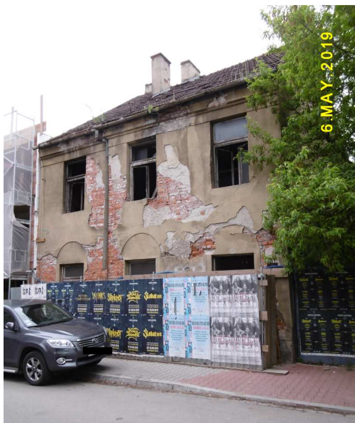
Fot. nr 397. Ruina domu pod nr 10 wybudowany w roku 1889.
