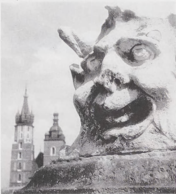
10. „Śmiejący się” maskaron z narożnika elewacji wschodniej na swoim nowym miejscu na elewacji zachodniej. Widoczne zniszczenia m.in. w postaci wżerów w twarzy i ukruszonego rogu. Fotografia wykonana przed konserwacją w 1957 r. Fot. H. Hermanowicz, MHMK, inw. 1736-2-n
