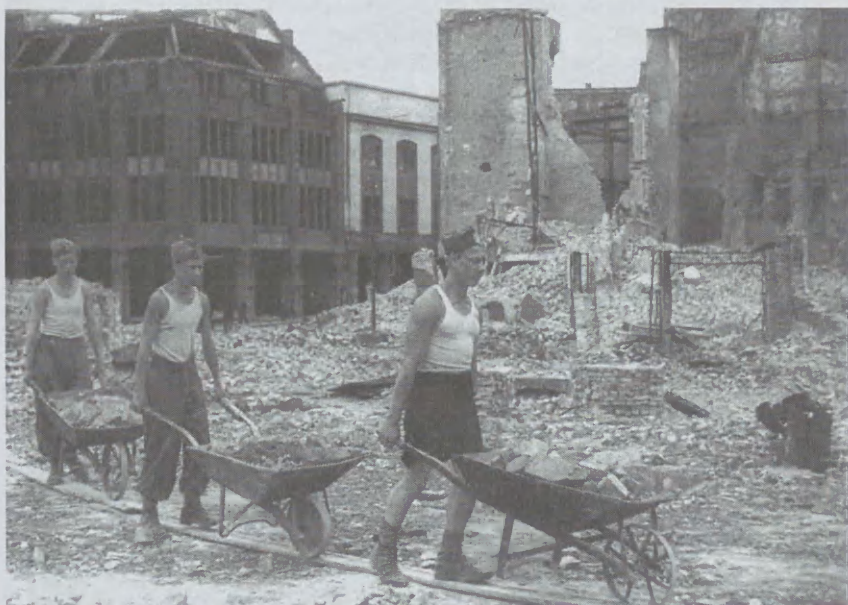
Fot. 2a, 2b. Praca brigady Służby Polsce przy budowie arterii Nadodrzańskiej w Szczecinie 1 V 48-30 X 48, 1 V 49-30 X 49, (źródło: album pamiątkowy, przekazany przez junaków prezydentowi miasta Szczecina, inż. mgr. Zarembie Piotrowi [pisownia oryginalna])
