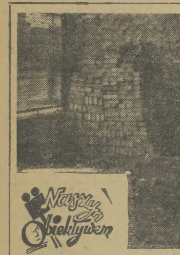
Przedsiębiorstwo budowlane, prowadzące roboty remontowe w Zakładzie Anatomii Opiszewca A. M. w Krakowie, ul. Kopernika 13 (Theatrum Anatomicum) posiada zapewnia krótką pamięć. W przeciwnym bowiem razie nie pozostawiliby na pastwę losu stołów cegieł, z których większość, już palona, powiewa się na dziedzińcu Zakładu. Miejsmy nadzieję, że niniejsze przypomnienie uratuje przed tym losem pozostałe, leżące dotąd jeszcze w zapomnieniu, i jeszcze całe cegły.
