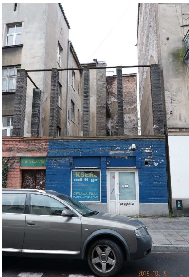
Fot. nr 246. Konstrukcja wiszącego (kiedyś) ogrodu przy kamienicy pod nr 20.
