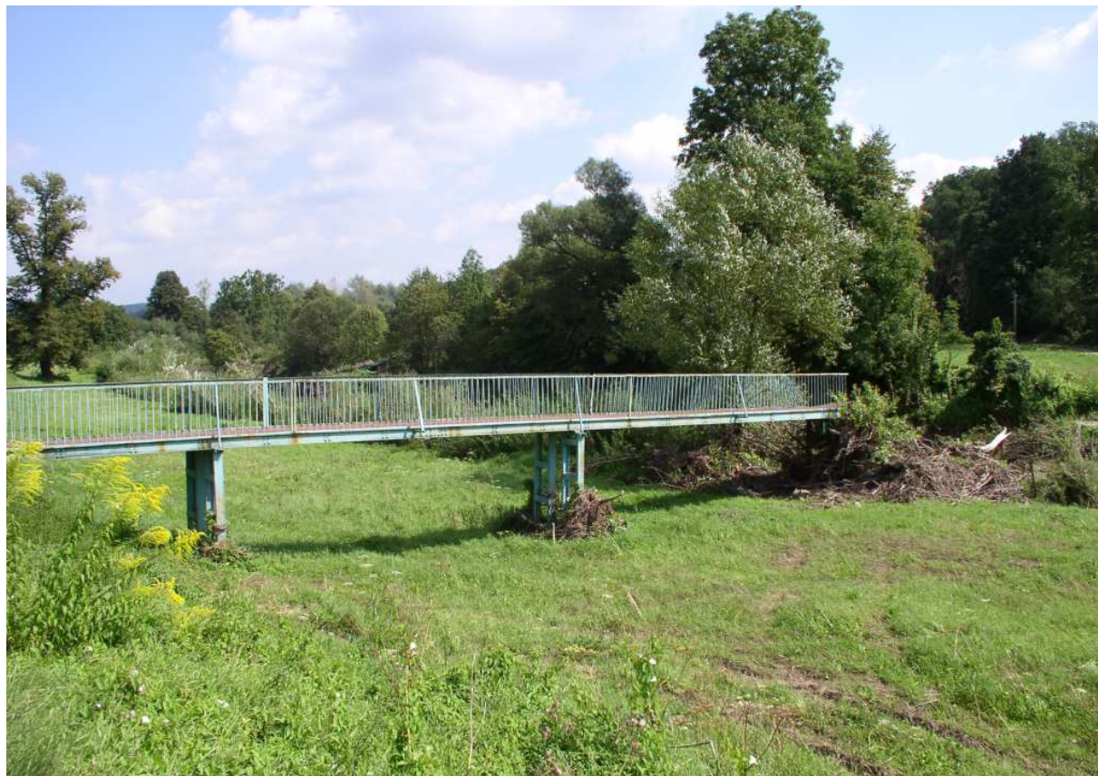
Fot. nr 39 (39-40). Most na Stradomce zerwany przez niedawną powódź. (20.08.2010)
