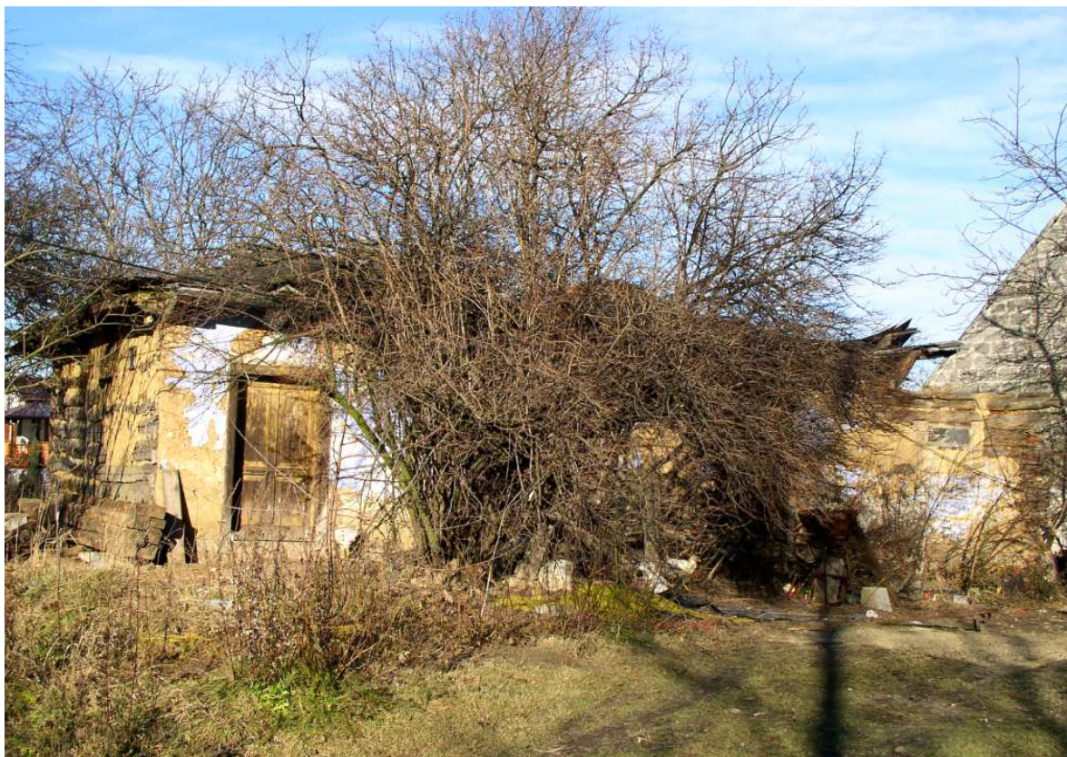
Fot. nr 140 (140-143). Ruina archaicznej, jednoizbowej chatki spod nr 10 (?), która mogła powstać w II połowie XIX wieku. (02.12.2008)
