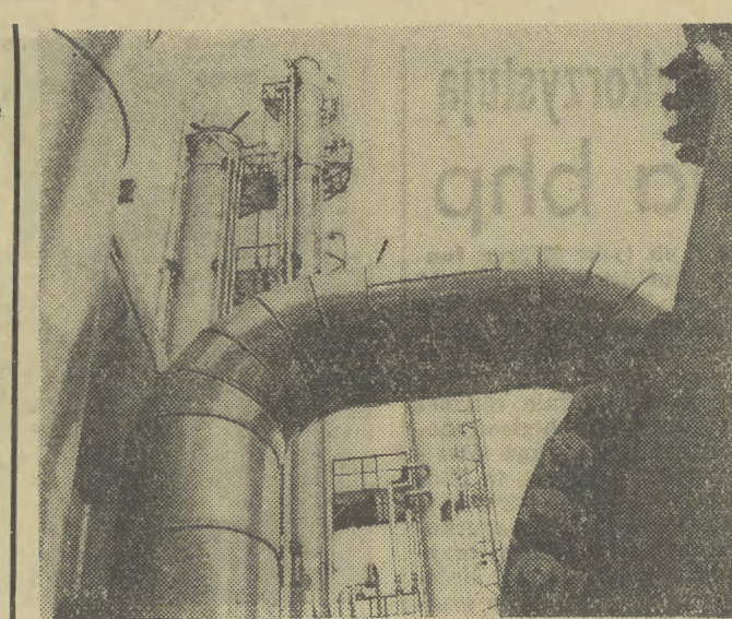
Ponad 9 mln ton ropy przerobił już płocki kombinat na benzynę, olej, asfalt, ksyleny i gaz od uruchomienia w nim pierwszych obiektów rafineryjnych, czyli w ciągu ok. 4 lat. CAF — Uchymiak
