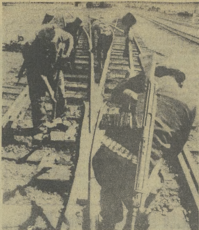
Na skutek niedawnej agresji wojsk rodyjskich na teren Mozambiku, zniszczonych zostało wiele obiektów cywilnych, zakładów przemysłowych oraz linii kolejowych. Na zdjęciu: uzbrojeni żołnierze przy pracy w mieście Chitua. Fot. CAF — UPI
