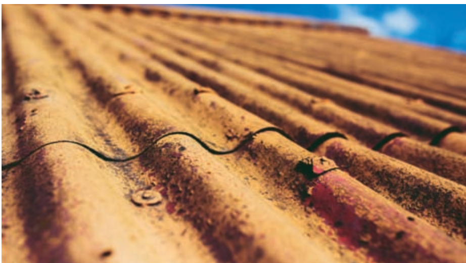
Płyty azbestowe na dachach erodują.
