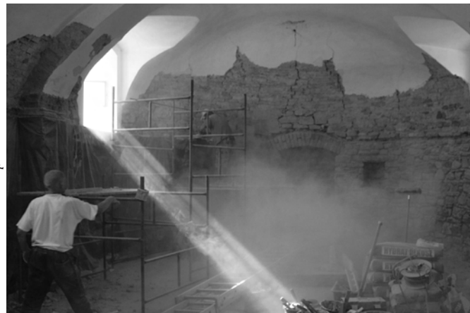
13 września 2016 – od sierpnia prace prowadzi zakład kamieniarski. Odkuwanie tynku ze sklepienia ujawniło poważne pęknięcia.
