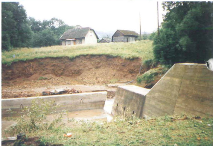
Uszkodzona zapora rzeczna
