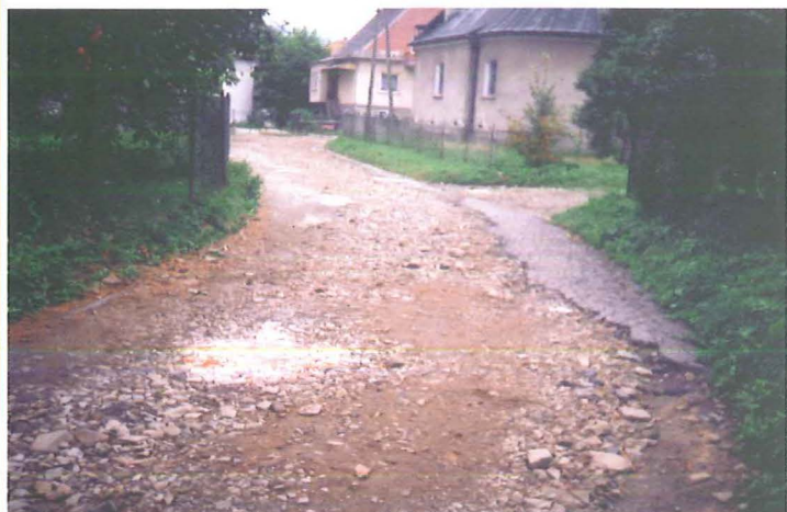
Zniszczone drogi i chodniki (na zdjęciu ul. Wąska)
