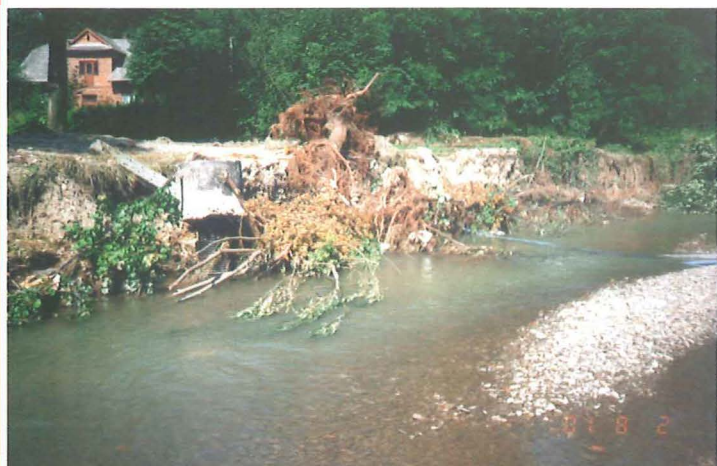
Uszkodzona sieć wodociągowa i kanalizacyjna na Zielonej
