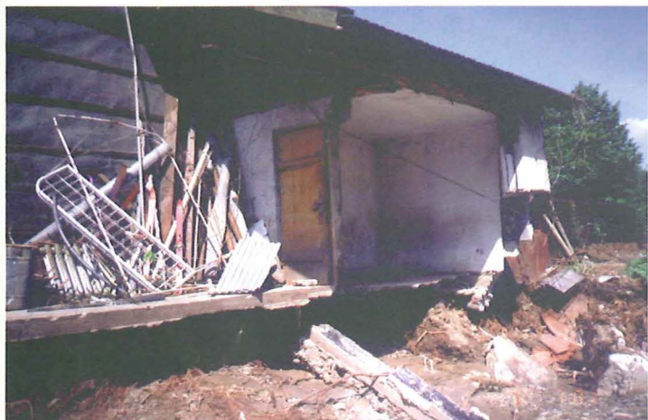
Zalany, uszkodzony budynek niedaleko taryaku
