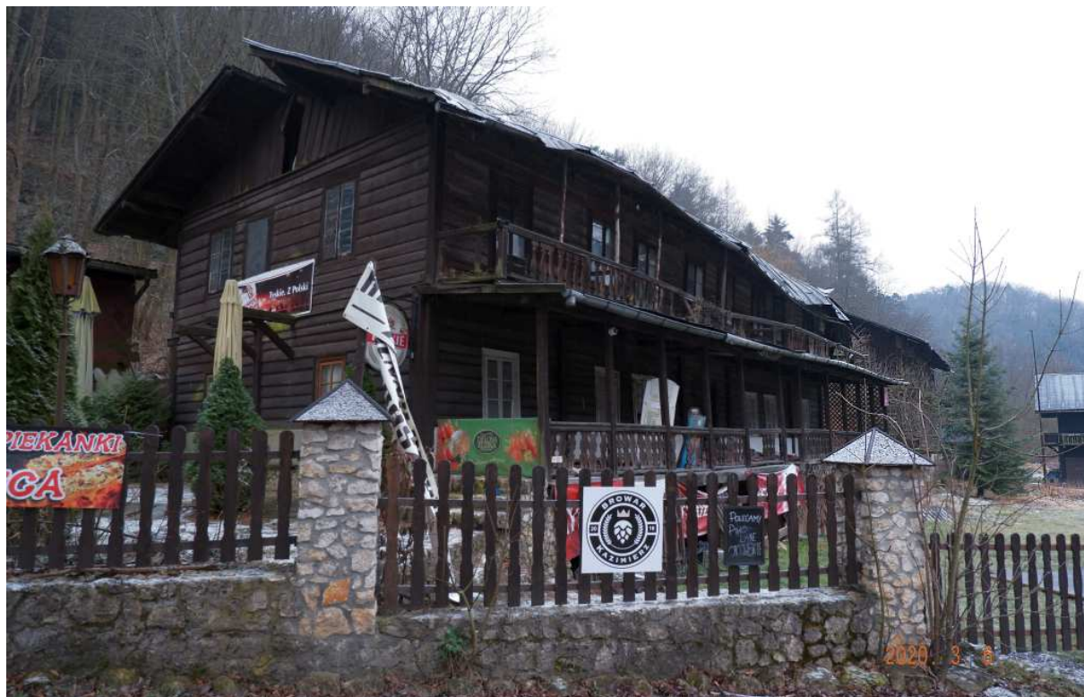
Fot. nr 76 (76-78). Ciągłe czynna i prowadząca działalność gastronomiczną drewniana wila w kompleksie Zawiszówki (pod nr 16), o której stanie technicznym lepiej nie mówić.
