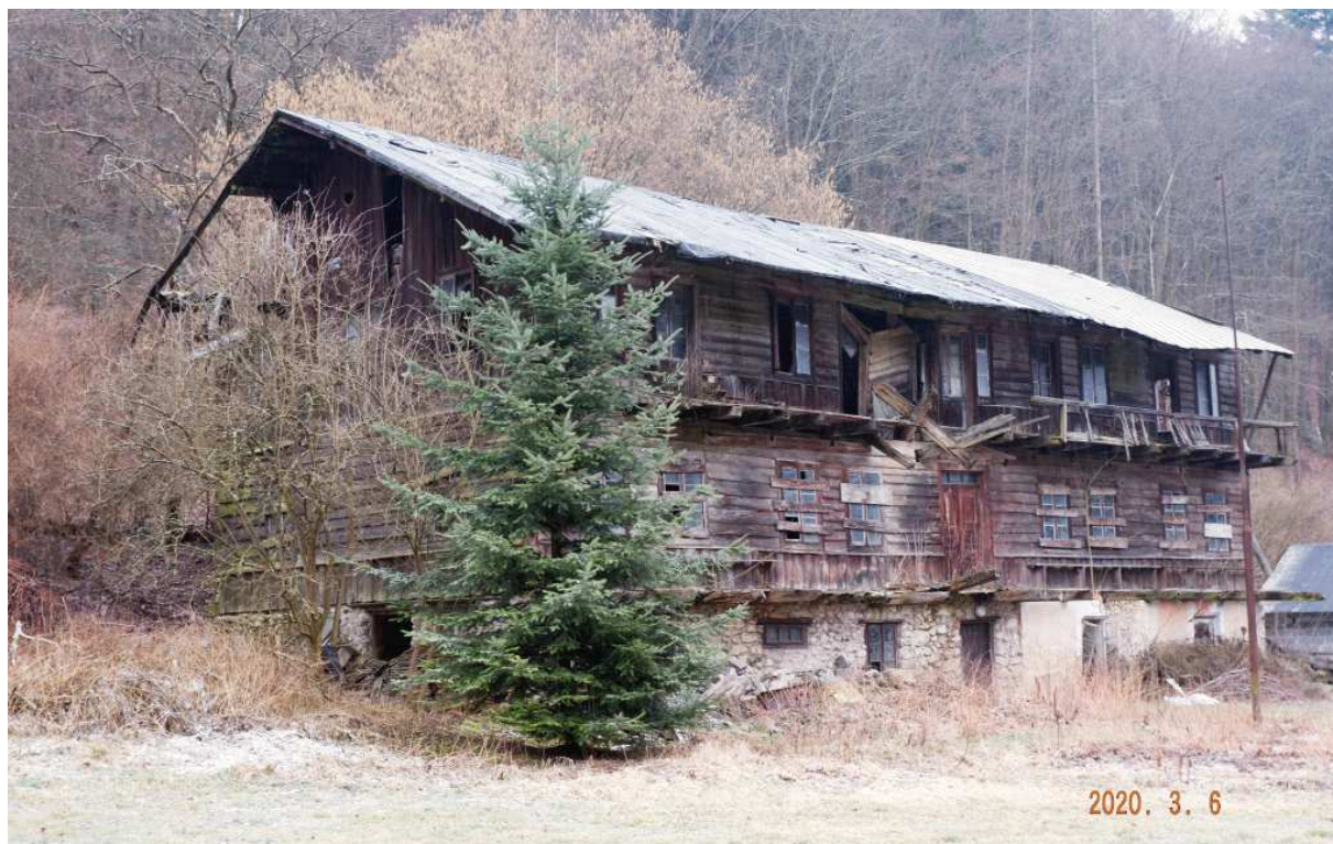
Fot. 81 (81-82). Drewniany obiekt pod nr 17, zwany willą. Jej stan techniczny jest równie krytyczny jak sąsiadki spod nr 16.
