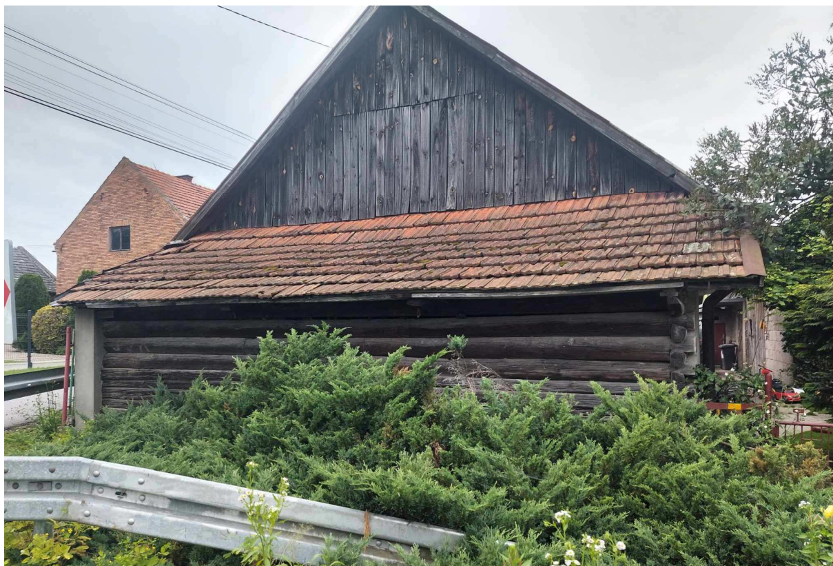
Fot. nr 12. Z dawnej chałupy pod nr 121 została oryginalna tylko ściana szczytowa. Reszta zniknęła pod sidingiem. (12.06.2024)
