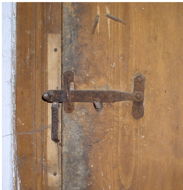
Fot. nr 251. Archaiczna zasuwka. (21.09.2009)
