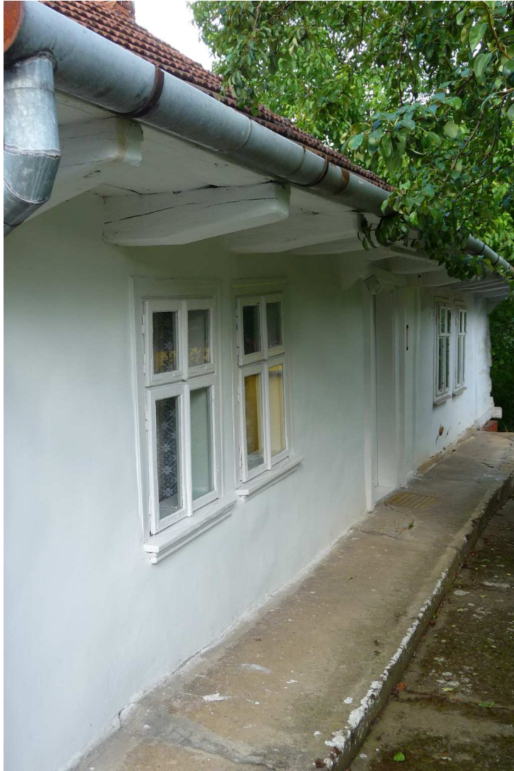
Fot. nr 297. Fasada z dwoma typami okien. Z lewej późniejsze typu skrzynkowego (około stuletnie), a z prawej oryginalne, typu ościeżnicowego. (04.07.2024)
