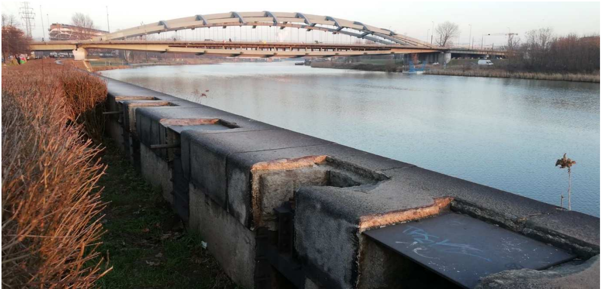
Fot. nr 172 (172-175). Umykające uwadze urządzenie zamykające odpływ ścieków z dawnej krakowskiej rzeźni, dziś usytuowane w sąsiedztwie galerii Kazimierz. (fot. Łukasz Opałek). (25.01.2020)
