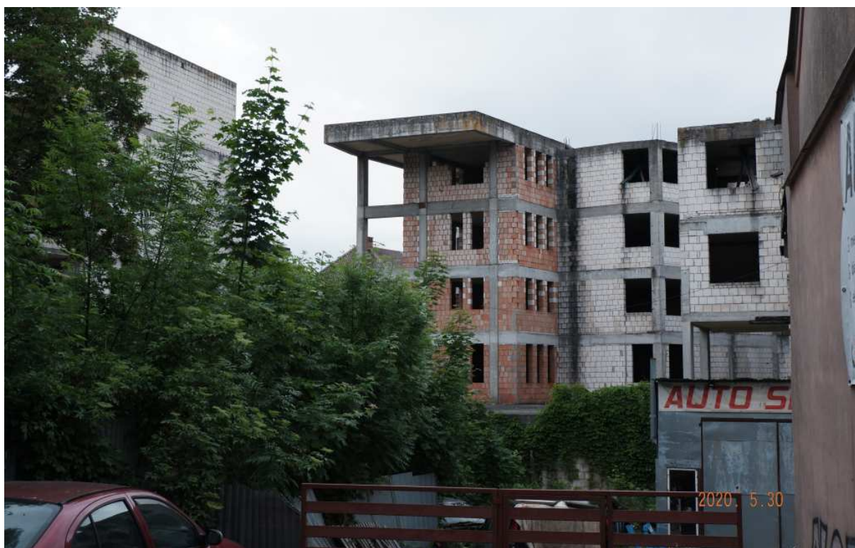
Fot. nr 156. Niedokończone blokowisko pod nr 71, które w stanie ruiny tkwi od początku lat 90. zeszłego wieku.
