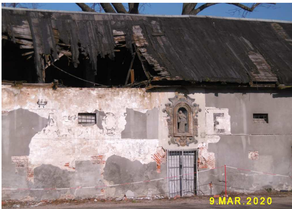
Fot. nr 28 (28-29). Bliskiego zawalenia się ściana budynku z zabytkową figurą.
