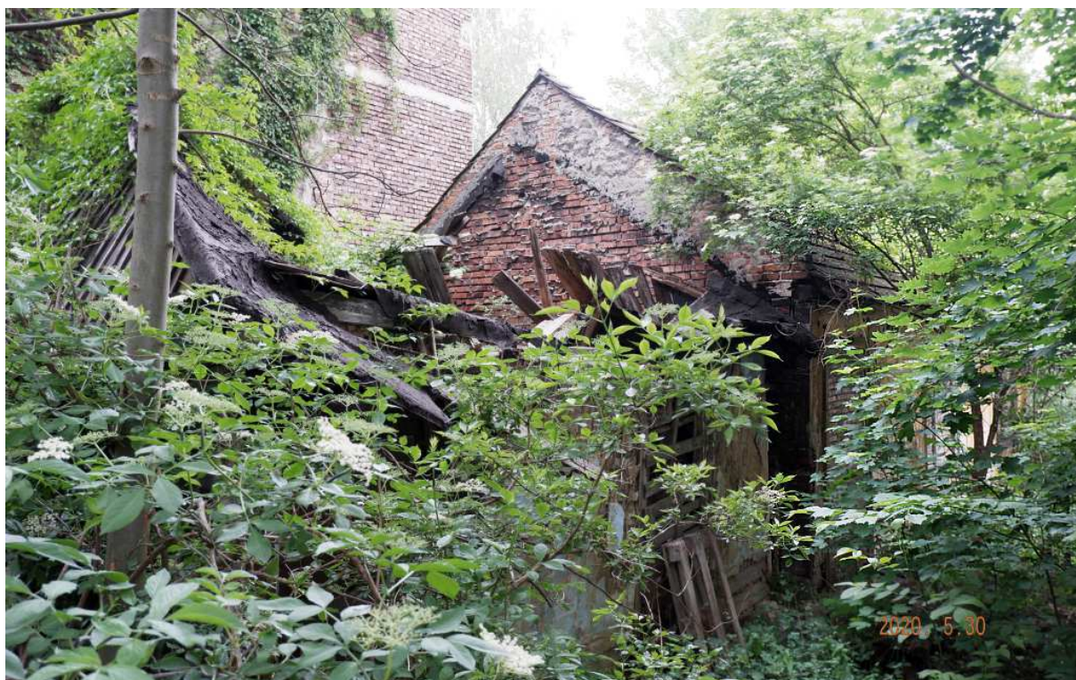
Fot. nr 155. Totalnie zrujnowane domy pod nr: 61 i 63.
