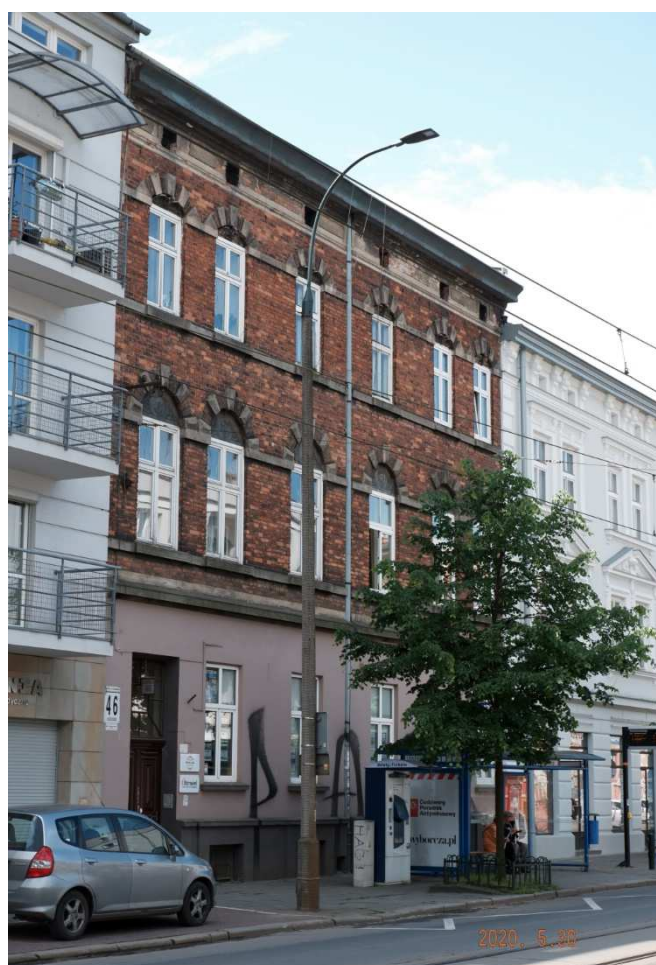
Fot. nr 90 (80-81). Kamienica pod nr 46, której dekoracja sgraffitowa nad oknami I piętra czeka na restaurację. Na szczęście znajduje się już w rejestrze zabytków.
