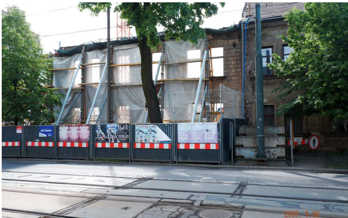
Fot. nr 91. A to już resztki domu pod nr 62.
