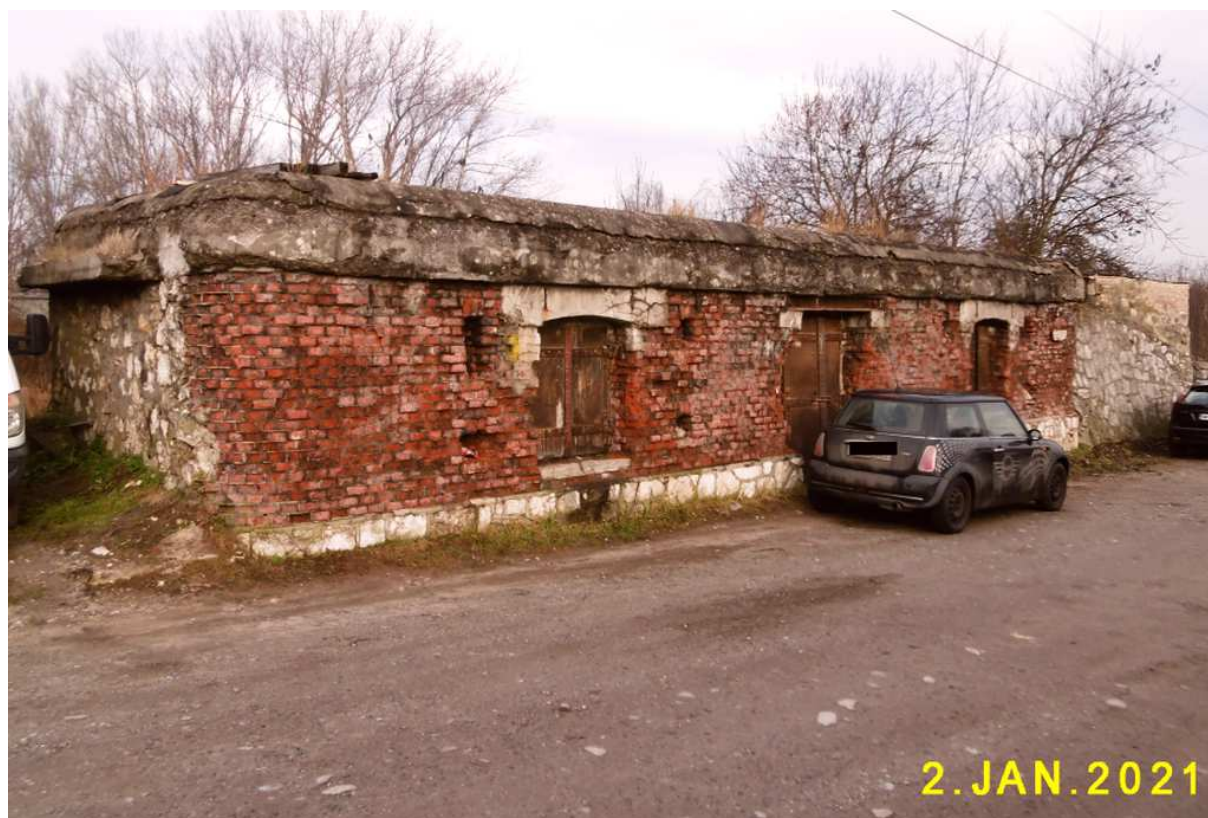
Fot. nr 108 (108-108a). Schron amunicyjny Podchruście za domem o numerze 172. Obiekt, który zachował wiele metalowych detali, prosi się o wsparcie konserwatorskie.
