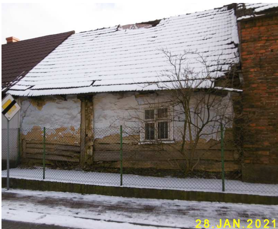
Fot. nr 399. Frontowa ściana niszczonej od lat drewnianej chałupy z ulicy Kijanki 28, która mogła powstać na przełomie XIX/XX wieku.
