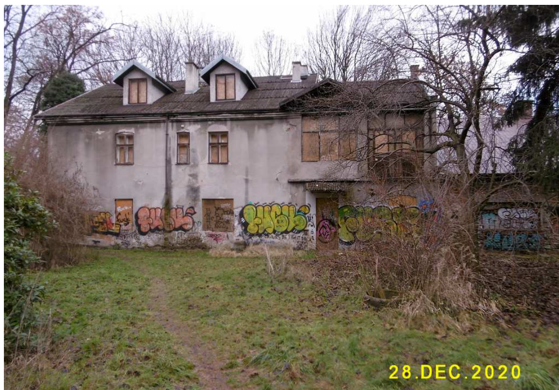
Fot. nr 214. Fasada dworu, który popada w coraz większą ruinę.
