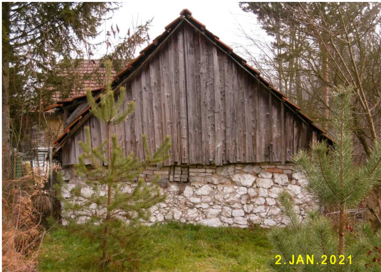
Fot. nr 86. Szczytowa ściana budynku gospodarczego przy ulicy Ojcowskiej 90.
