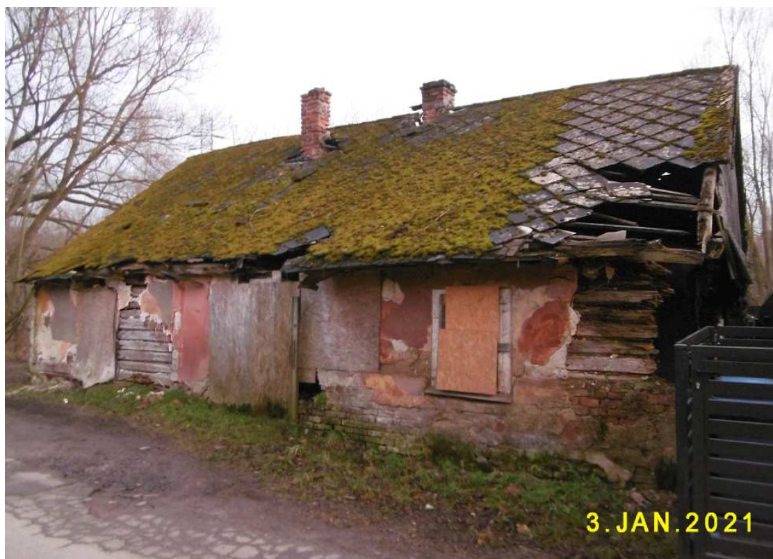
Fot. nr 281. Dogorywający od lat drewniany dom z ulicy Mokrej 26. Od strony ogrodu posiada on odkryty ganek, ale nie sposób tam dotrzeć.
