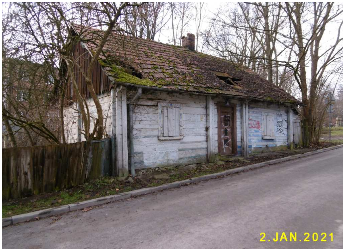
Fot. nr 60 (60-62). Ruina chałupy spod nr 25, wybudowanej w roku 1912. Początkiem jej końca jest dziurawy dach.
