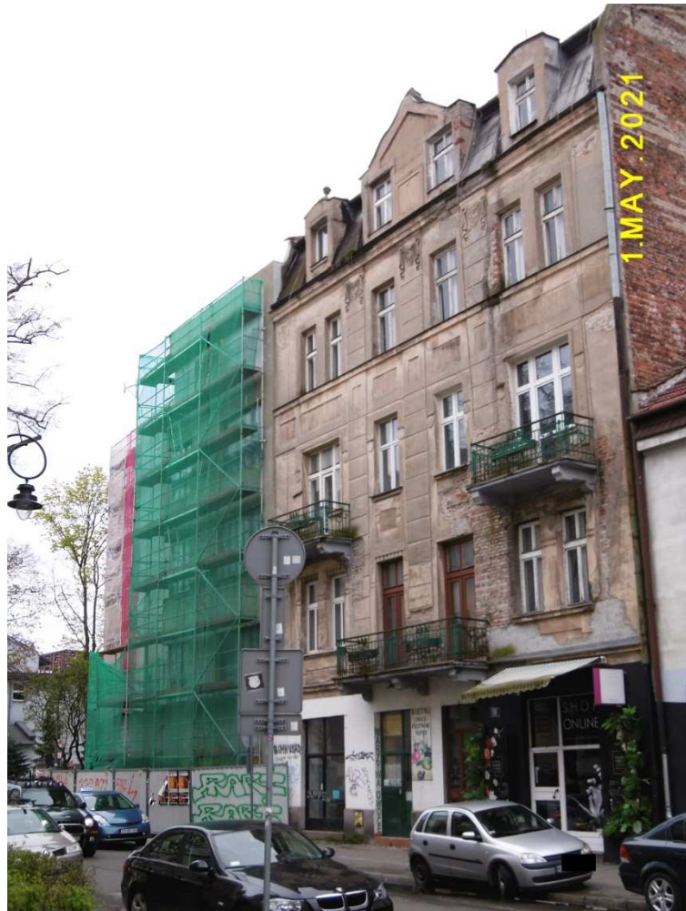
Fot. nr 48 (48-49). Kamienica pod nr 20 na etapie przed planowanym remontem..
