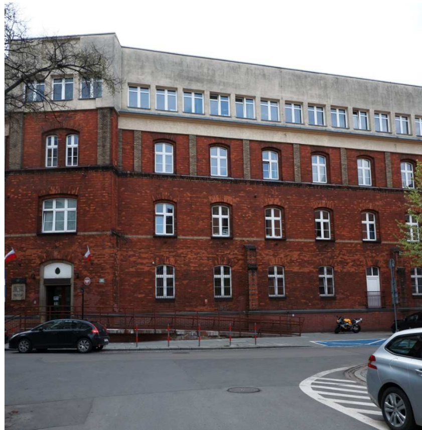
Fot. nr 119. Nadbudowa, która zniszczyła oryginalny kształt fasady.
