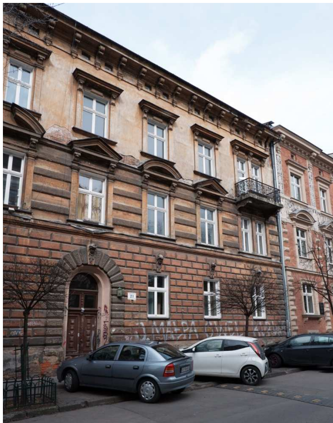
Fot. nr 148. Kamienica pod nr 21, która czeka na remont elewacji. (14.03.2021)
