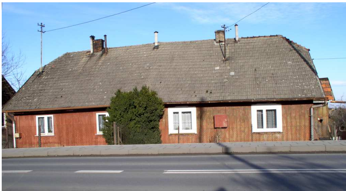
Fot. nr 166. Dawna chałupa spod nr 18, której fasadę zniekształciły współczesne okna. (02.12.2008)
