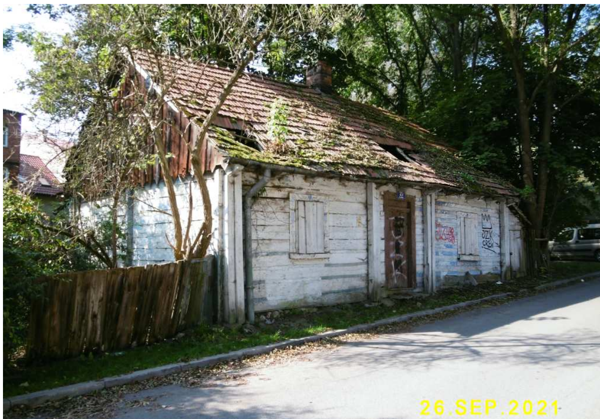
Fot. nr 229 (229-230). Chałupa z roku 1912 spod nr 25. Z uwagi na zły stan techniczny nie jest brana pod uwagę pod kątem przeniesienia do krakowskiego skansenu.
