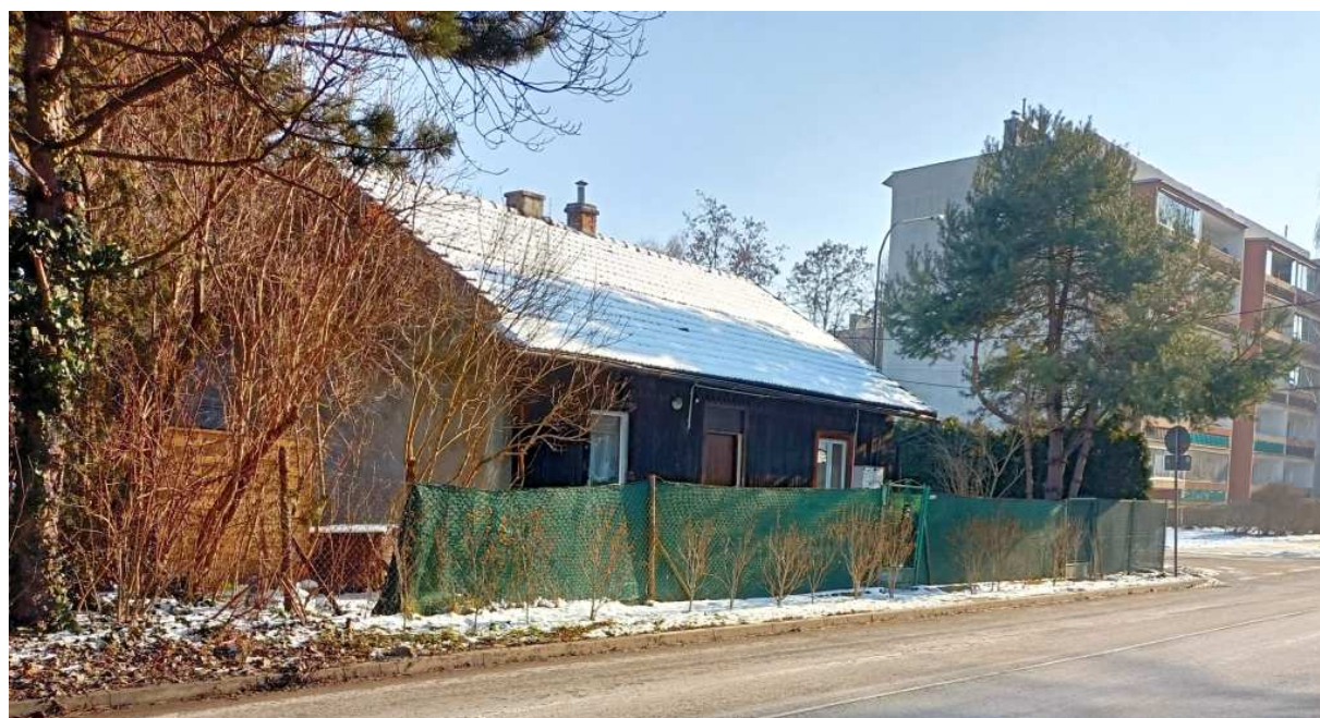
Fot. nr 67. Zniekształcona przez nowe okna bez podziałów fasada domu spod nr 68.
