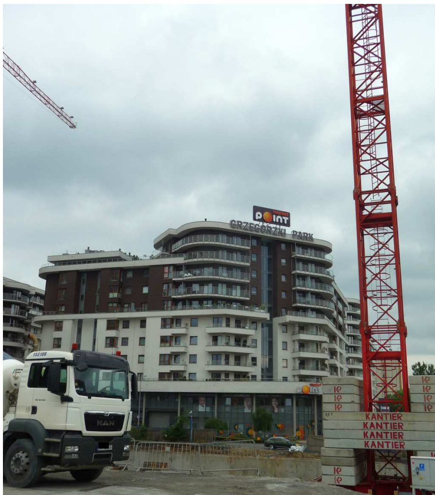
Fot. nr 373 (373-374). Gwałtownie przybywa nam „betonowych parków” jak ten: Grzegorzki Park, z ulicy Mogiłskiej 51/róg z Francesco Nullo. (10.06.2022)
