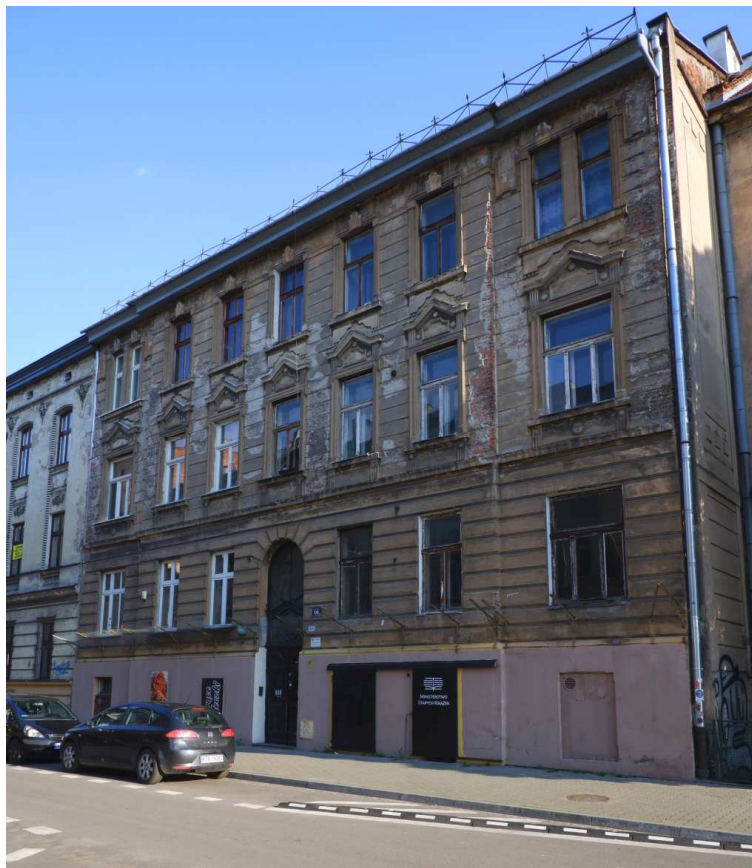
Fot. nr 104. Potwornie zniszczona fasada kamienicy pod nr 16. (23.04.2022)
