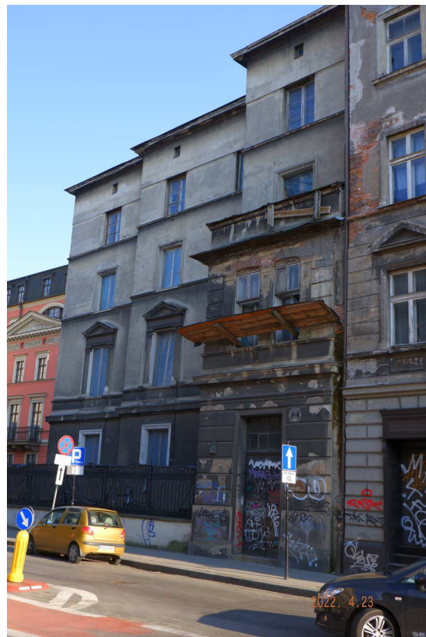
Fot. nr 93 (93-97). Wzdłuż ul. Krupniczej. Oczekująca od lat na remont kamienica nr 18.
