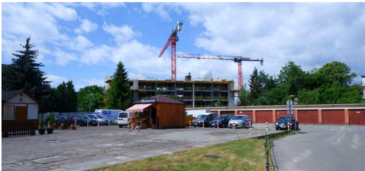
Fot. nr 233. W stronę ulic: Orawskiej i Konopnickiej. (28.05.2022)
