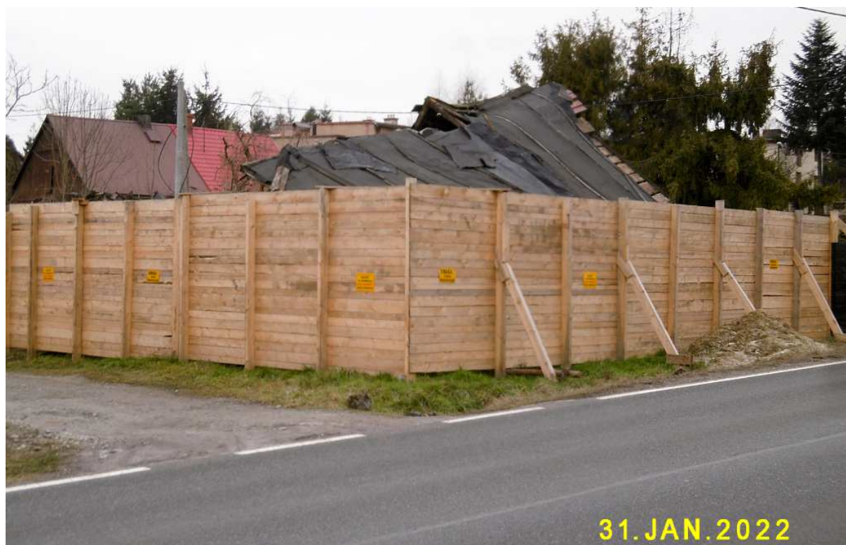
Fot. nr 101 (101-103). Agonia chałupy, zapewne z końca XIX wieku, spod nr 43. Choć znajduje się w Gminnej Ewidencji Zabytków aktualnie jest na etapie wyburzania.
