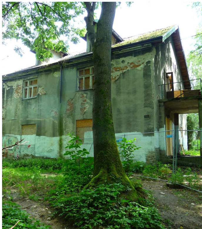
Fot. nr 174 (174-177). Stary dwór Bemów ciągle czekający na remont. (12.07.2022)
