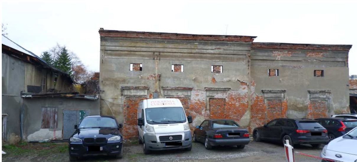
Fot. nr 183 (183-184). Zrujnowane, XIX-wieczne budynki klasztornej oficyny. (17.12.2023)
