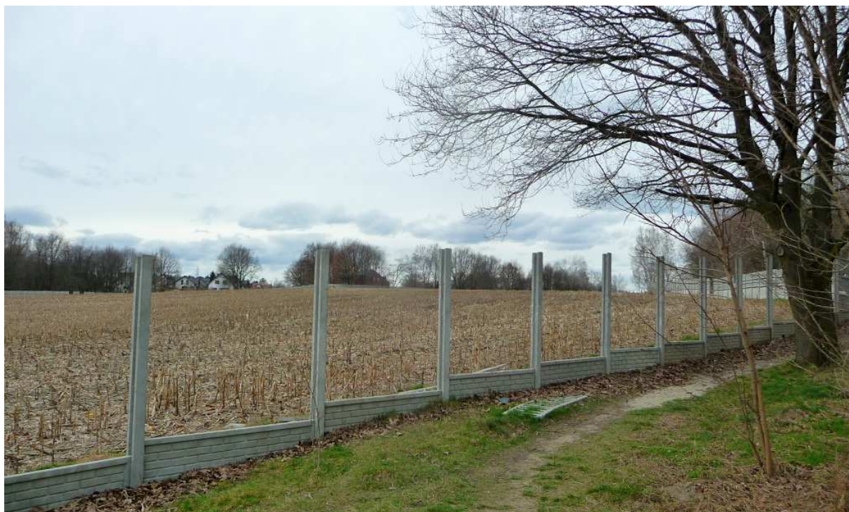
Fot. nr 536. Nie ma litości dla betonowego wygradzenia. (25.02.2024)
