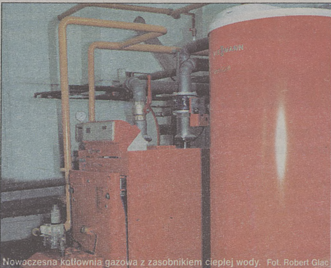
Nowoczesna kotłownia gazowa z zasobnikiem ciepłej wody. Fot. Robert Glac
