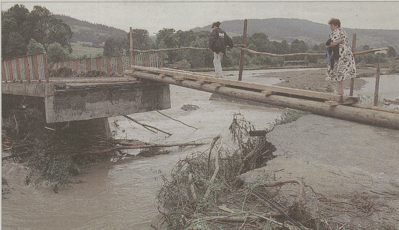
Wieś Budzów koło Suchej Beskidzkiej została odcięta od świata – zerwane zostały wszystkie mosty, zniszczeniu uległy drogi
