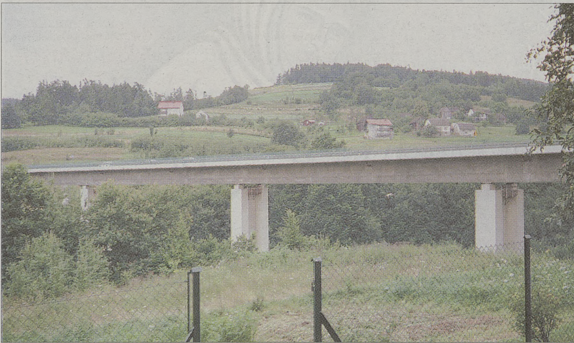
30-metrowy most w Świnnej Porębie, tu w zasadzie codziennie ktoś skacze...
