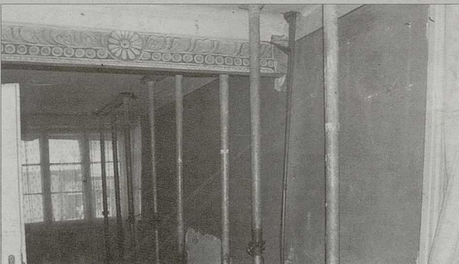
...doszło do skrzywienia ścian, które nieodpłatnie podparli pracownicy Chemobudowy
