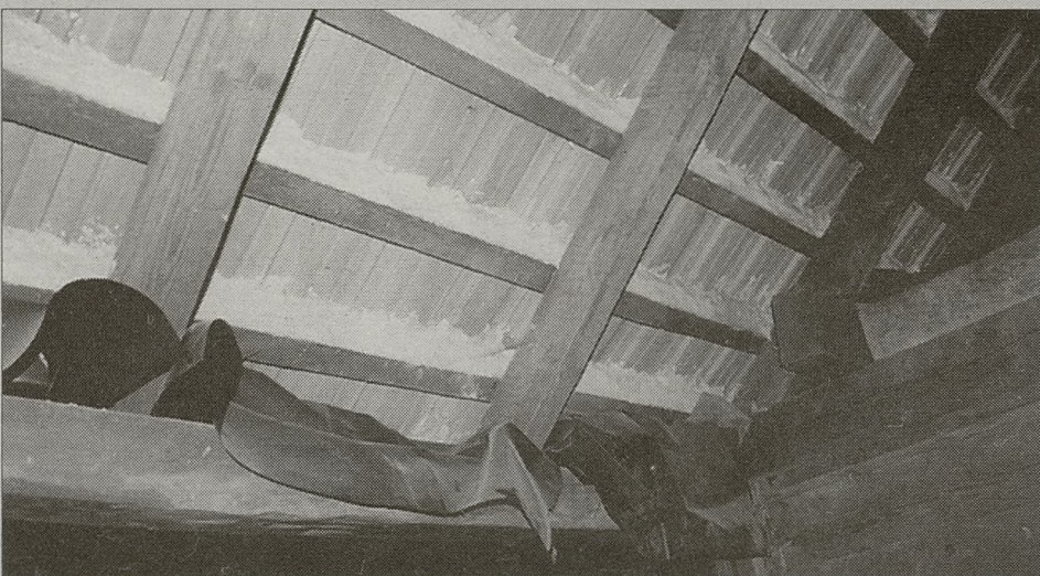
Najpierw widać było niebo, potem dach uszczelniono cementem i...
