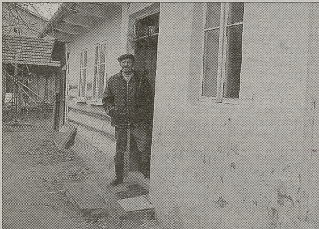
Dom w Radziszowie. Na ścianach widać, do jakiej wysokości docho- dziła woda. Fot. autorka
