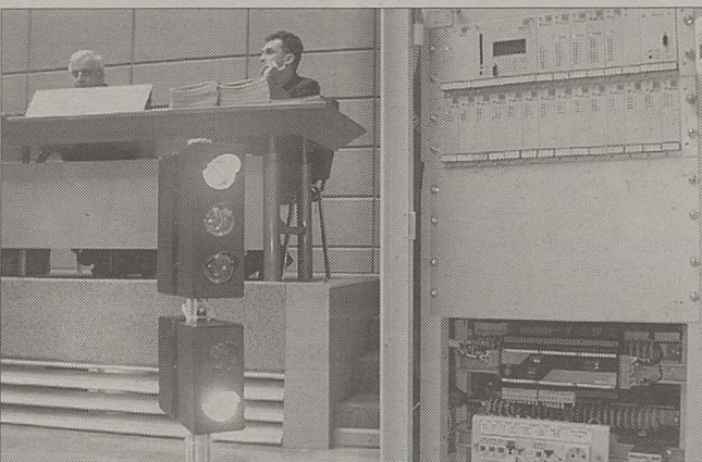
Sterownik sygnalizacji świetlnej ASC-24 może samodzielnie sterować ruchem na jednym lub kilku skrzyżowaniach
