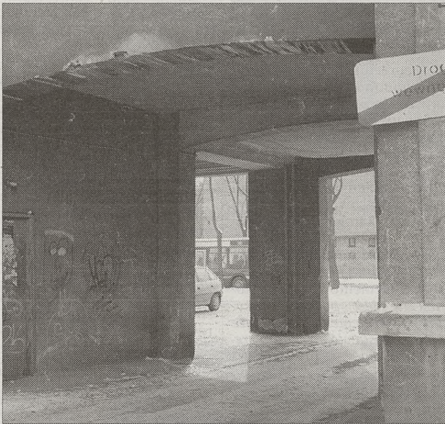
Aby wjechać na osiedlowe podwórka w starej części Nowej Huty, wozy strażackie muszą przecisnąć się przez dość wąski i niski wjazd, jakich w tej dzielnicy jest kilkadziesiąt. Ślady na górnym łuku tunelu na os. Góralskiego wskazują, że nie jest to proste.
