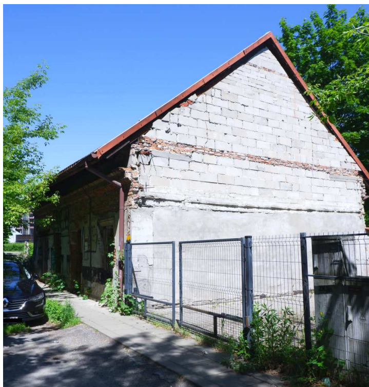
Fot. nr 74. Ruina murowanego domu pod nr 6. (12.05.2024)
