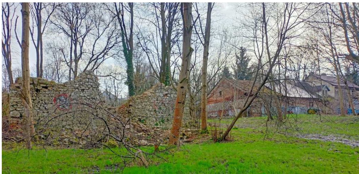
Fot. nr 251. Ruina budynku gospodarczego przy dawnym folwarku. (17.03.2024)
