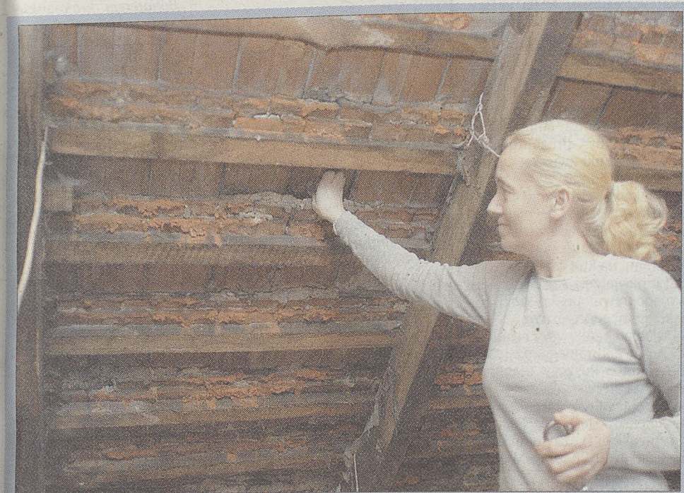
Agnieszka Kotnis prezentuje stan dachu w bloku przy osiedlu Na Skarpie 61
