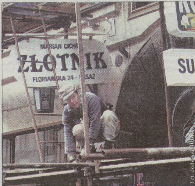
Nawet upadek z niskiego rusztowania może być niebezpieczny
