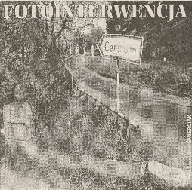
Nowy Sącz. Kierowcom jadącym z dzielnicy Wólki do centrum miasta najdogodniej jest skręcić z ul. Kościuszki w ul. Szwedzką. Tak wiele pojazdów tu skręca, że kompletnie zniknął jeden cokół balustrady mostu na Żeglance. Przechodzień lub auto mogą wpaść do głębokiego koryta, którym płynie potok. Może więc warto naprawić barierki mostu zanim zdarzy się tragedia (ss)
