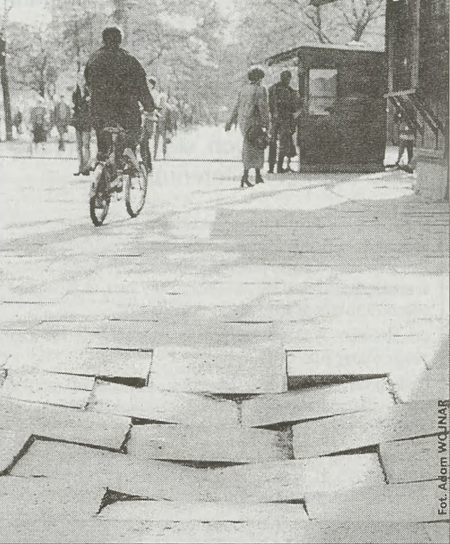
Kraków, Nowa Huta. Pułapka na pieszych czyha na chodniku przy al. Solidarności. Źle ułożone płyty zapadają się, łatwo tu złamać nogę
