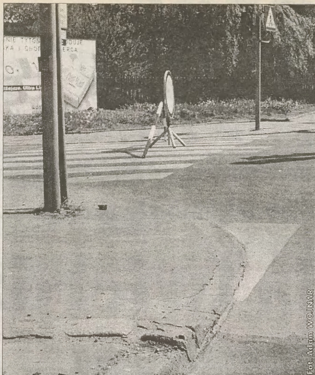
Niskie krawężniki dla inwalidów. Szkoda tylko, że tak zniszczone, że można się na nich zabić
