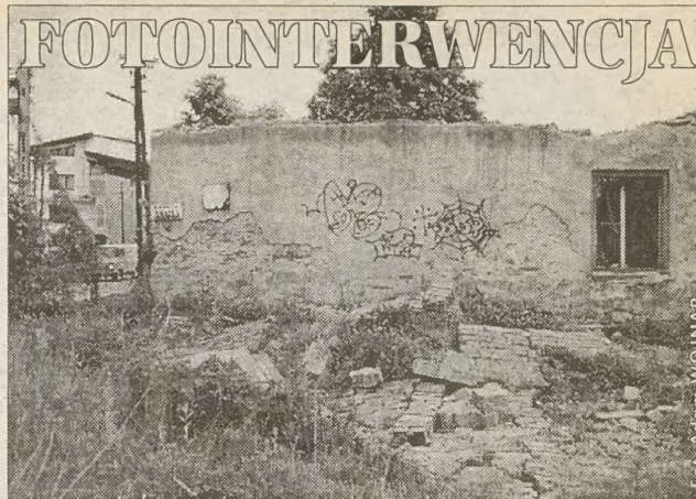
Kraków. Rudera na skrzyżowaniu ulic Junackiej i Chełmskiej wciąż straszy. Prowadzi tędy droga na międzynarodowe lotnisko...
